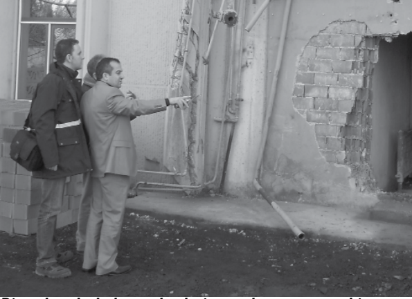
Bina dışında bulunan boylerin, patlama sonrası binaya ve ekipmanlara verdiği zarar
