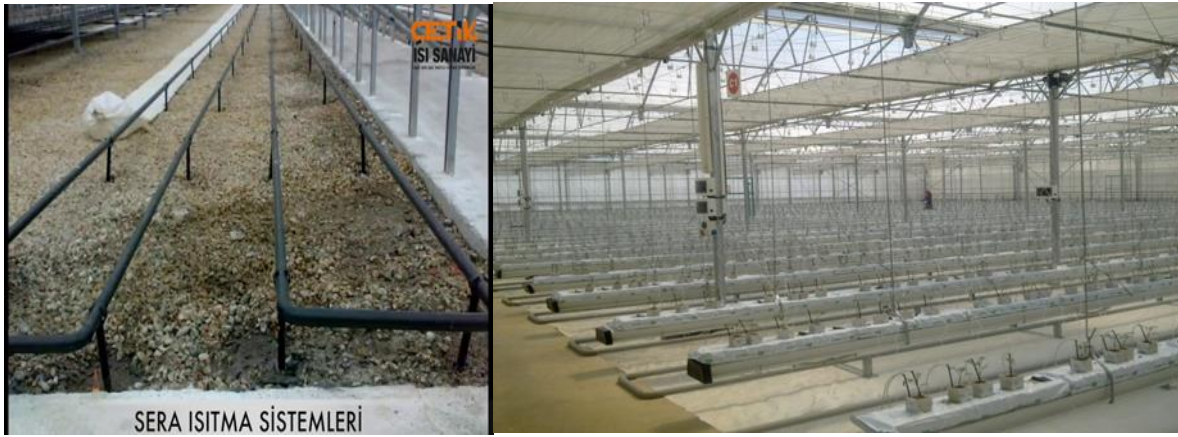
Şekil- 3 Merkezi sıcak sulu sera ısıtma sisteminin görünüşü.
